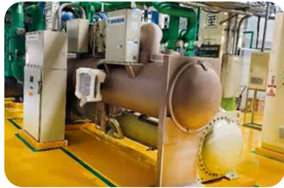
▲ 職訓場購置先進科技設計之水冷高效滿液離心冰水機
