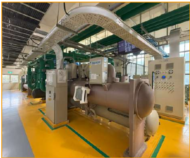
■ 桃竹苗分署冷凍裝修甲級第3站中央空調系統試車調整及維修訓練設備
